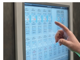
更新後の温度制御システムの操作パネル
