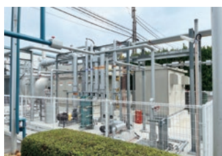
コージェネレーションシステム (滋賀第二工場)
