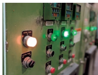
更新前の温度制御システム操作パネル
